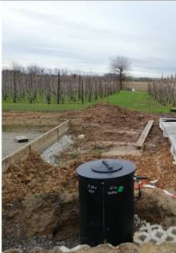
Bufferput voor opvang restwater na slibafscheider + Dompelpomp voor overpompen restwater van opvangput naar buffervat
